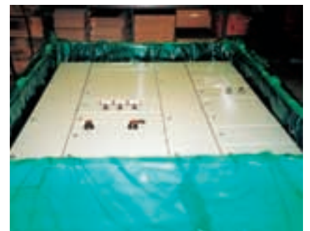
ZERUST® Valeno kalvolla suojattu sähkökaappi.
